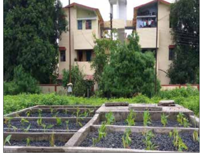
चित्र: उमरेर टाउनशिप डब्ल्यूसीएल में फाइटोरिड टेक्नोलॉजी के साथ एसटीपी
