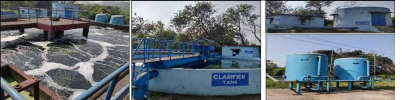
चित्र: सीवेज ट्रीटमेंट प्लांट (1.7 एमएलडी), लखनपुर ओसी, एमसीएल
