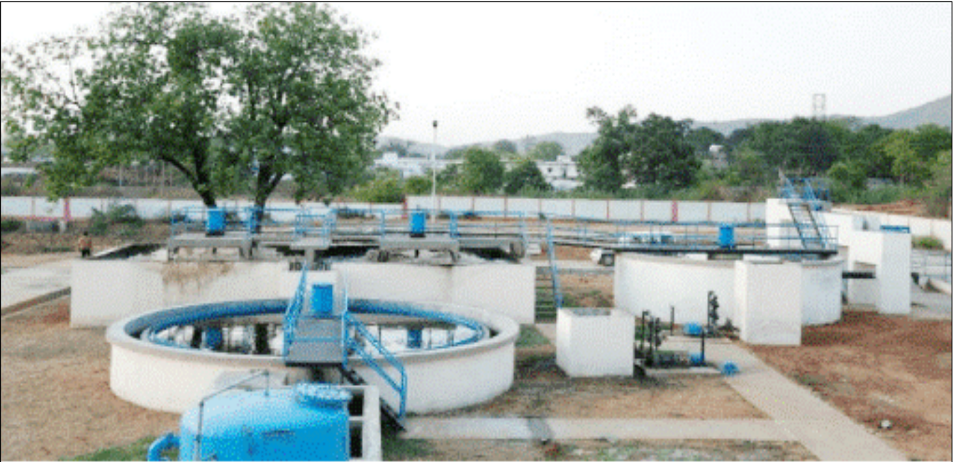
चित्र: ब्लॉक-बी, एनसीएल में 0.8 एमएलडी एसटीपी
