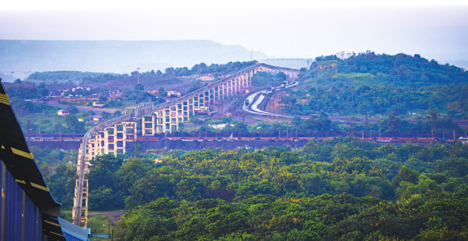
ओडिशा के महानदी कोलफील्ड्स लिमिटेड के तालचर कोलफील्ड्स में पाइप कन्वेयर के जरिये कोयला परिवहन के लिए निर्माणाधीन ढांचा
