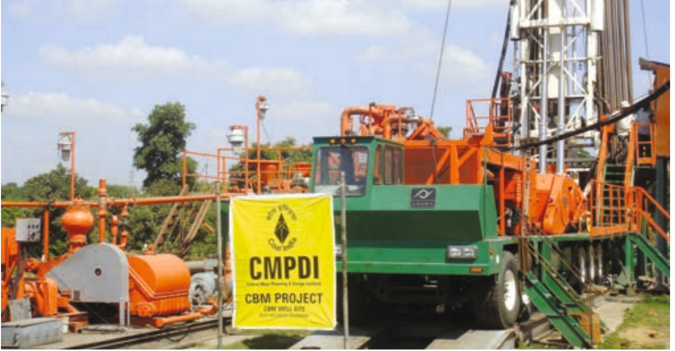
झारखंड में भारत कोकिंग कोल लिमिटेड के मुनिडीह क्षेत्र में कोल बेड मिथेन (सीबीएम) प्रोजेक्ट
